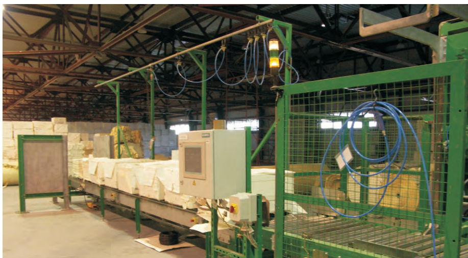
Загрузочный цепной транспортер с пневматическим удалением проволоки
