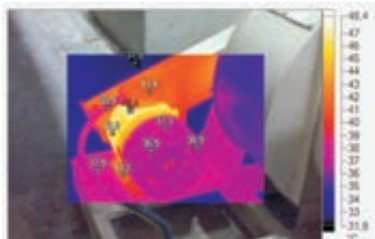
Analýza termovize elektromotoru ventilace v Dentashi
